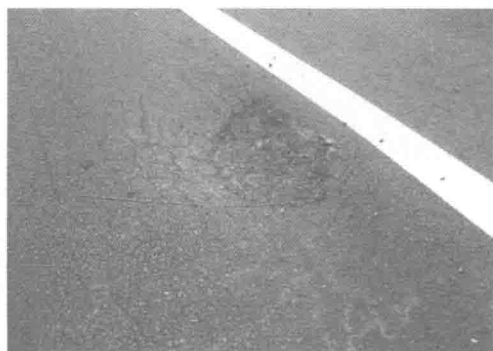
图 1.2-6 承载力不足引起坑槽
