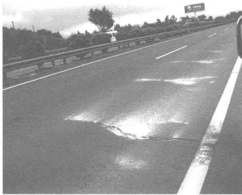
图 1.2-2 反射裂缝处唧泥
