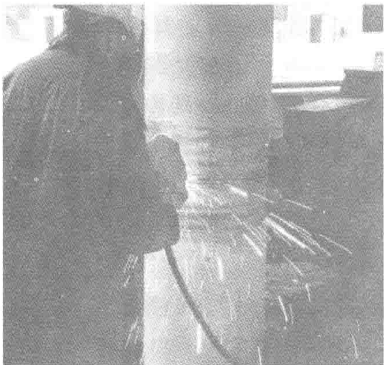
图 1-1 焊接未做到对称焊接
