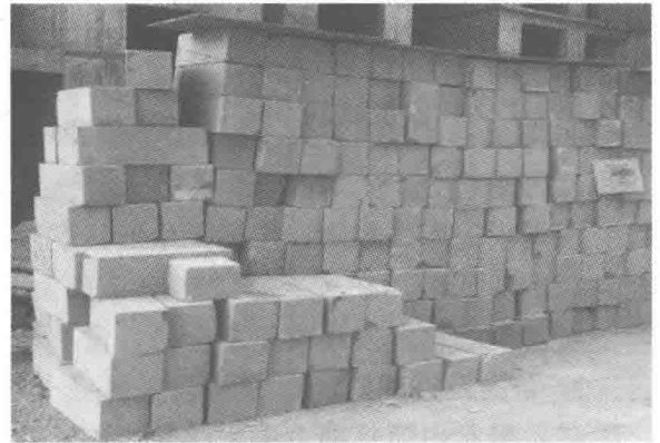
图 1-15 砌块码放不整齐，且码放高度超过 1.5m
