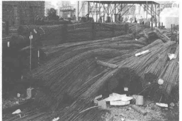
图 1-2 原材码放混乱，场地未硬化，不便通风排水，原材锈蚀
