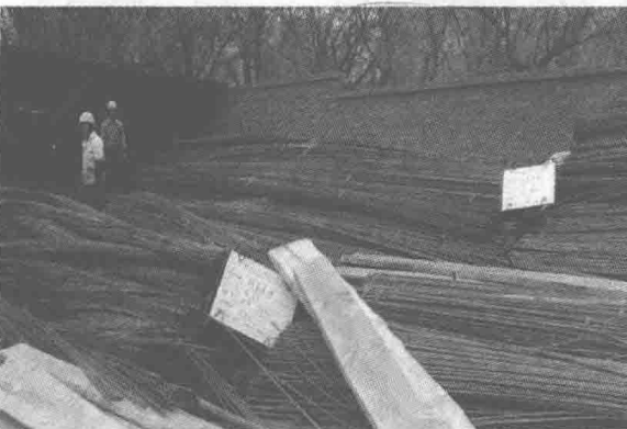
图 1-3 钢筋原材未分类码放
