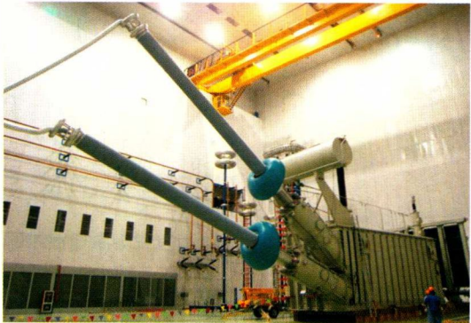
图 1-8 向上工程复龙换流站 800kV 换流变压器
