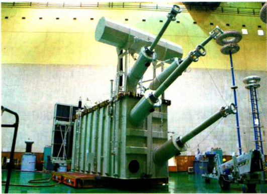
图 1-3 高岭背靠背换流站换流变压器（型式一）
