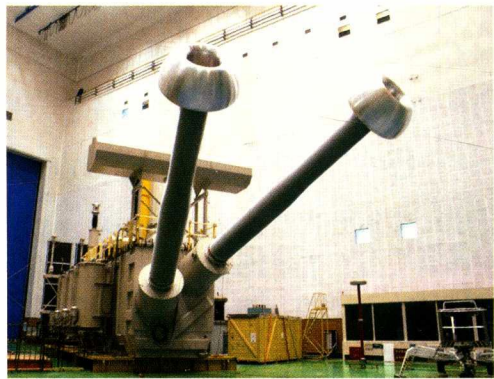
图 1-6 宁东换流站 660kV 换流变压器
