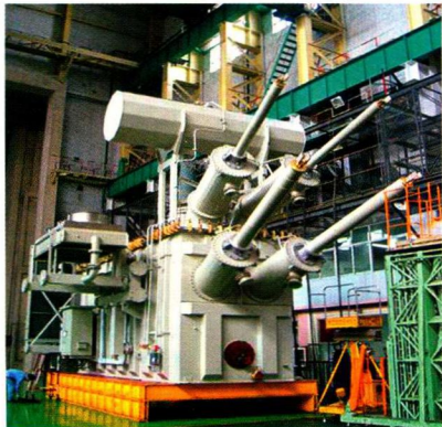
图 1-4 高岭背靠背换流站换流变压器（型式二）
