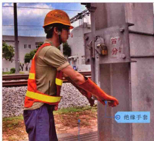
操作人员拉合电气设备刀闸时，佩戴绝缘手套，实现与电气设备操作杆之间的电气隔离
