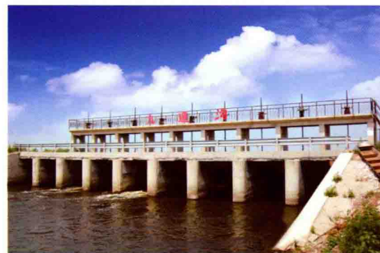
林甸东升水库泄洪闸
