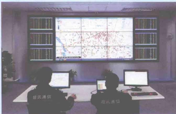
代维管理监控中心
