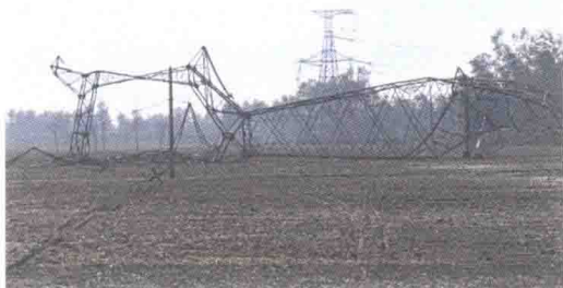
图 1-3 402 号塔受损情况
