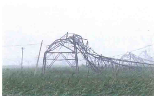
图 1-4 N131 号塔受损情况
