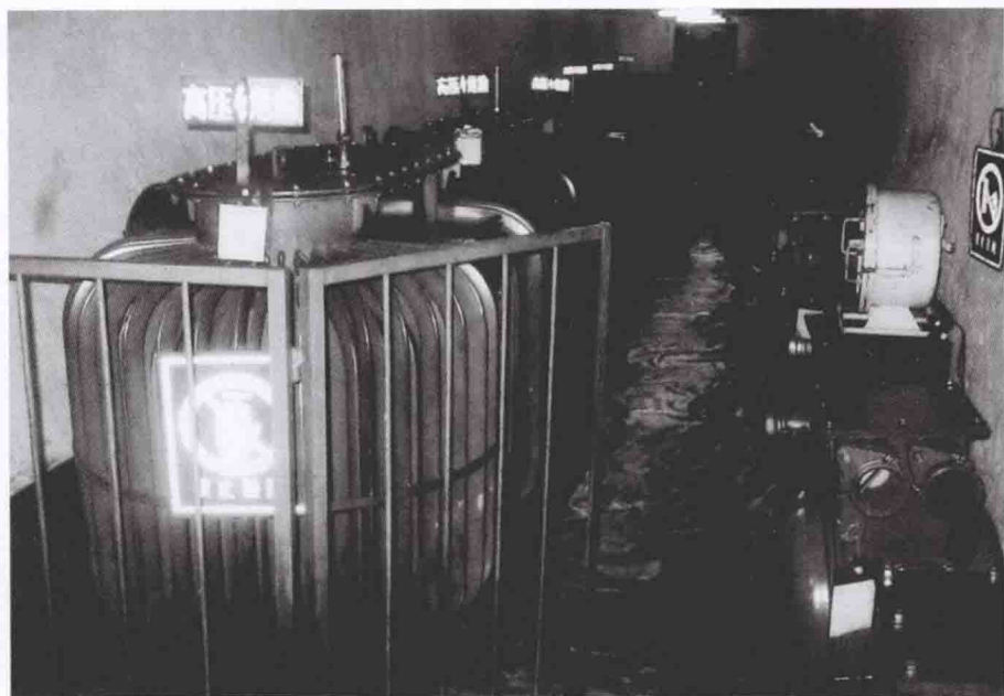
创业初期的井下中央变电室
