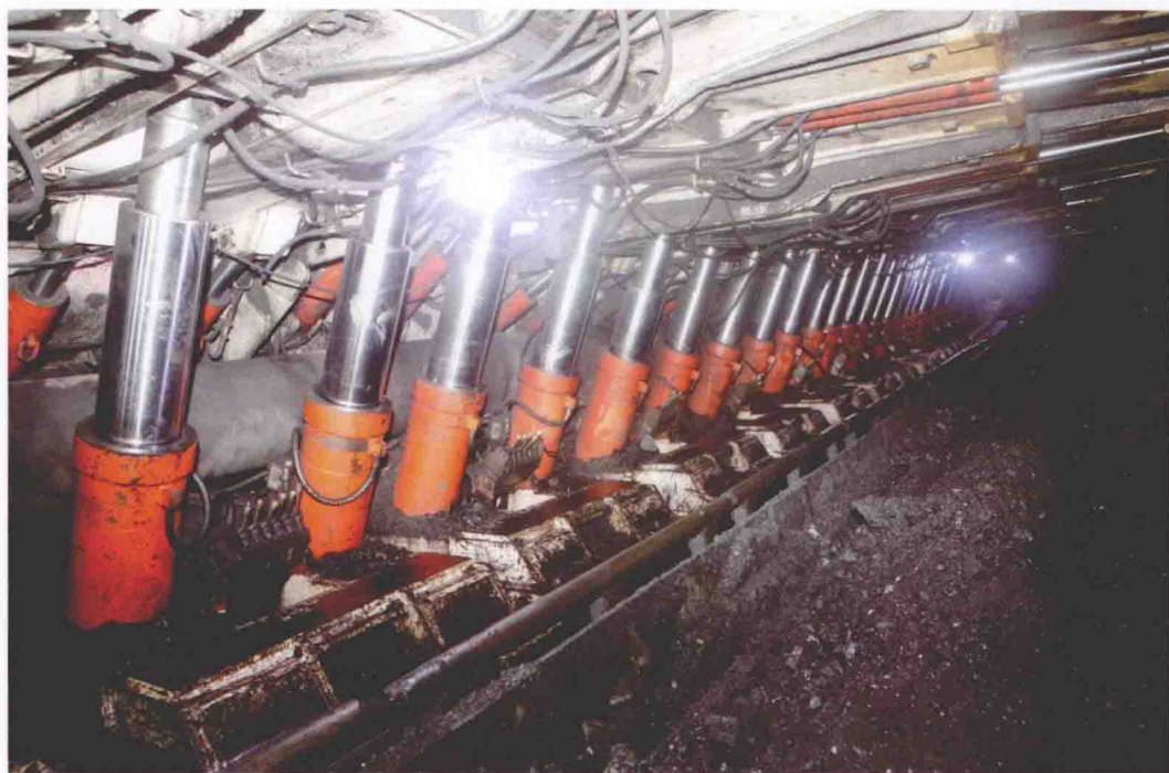
现代化的井巷综采液压支架
