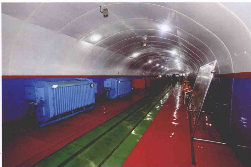
现代化的井下中央变电室
