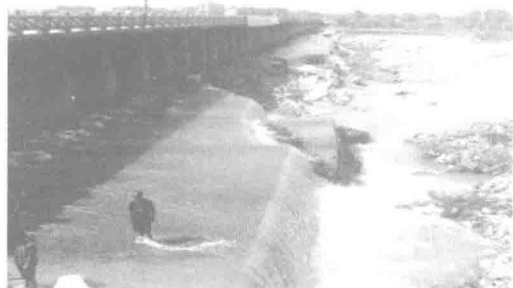
图0-1-4 多次加固改建后的西安灞河古桥(2002年 6月9日洪水过后,高冬光摄)
