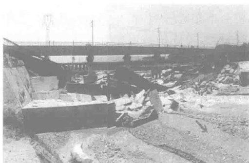
图0-1-3 陇海铁路灞河老桥(1934年建)水毁 (2002年6月9日洪水过后,高冬光摄)
