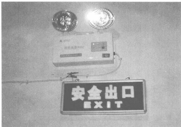
图 1-13 楼宇应急照明
