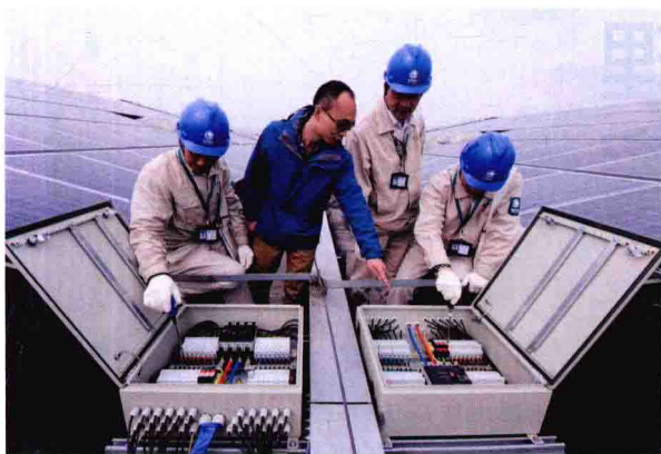
宜兴年均发电量 956 万千瓦时的光伏项目
