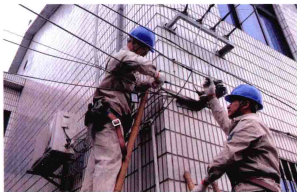
应急演练保供电
