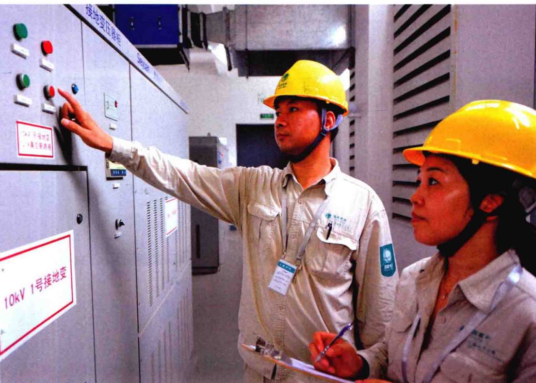
保障电网安全稳定运行，变电站特巡
