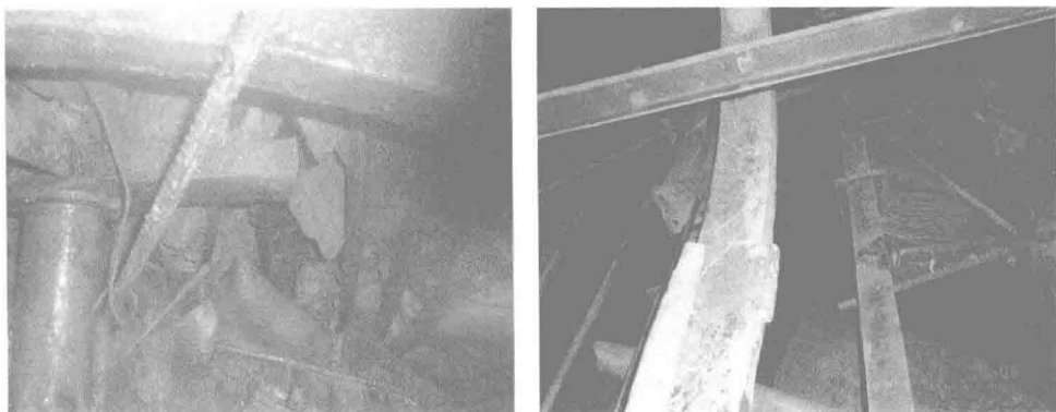
图 1-2 初期支护变形破坏
