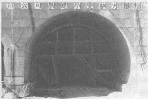
图 1.2 云南某隧道洞口偏压裂缝
