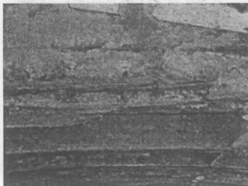
图 1.3 某码头梁底板面钢筋严重锈蚀 (张苑竹,2003)
