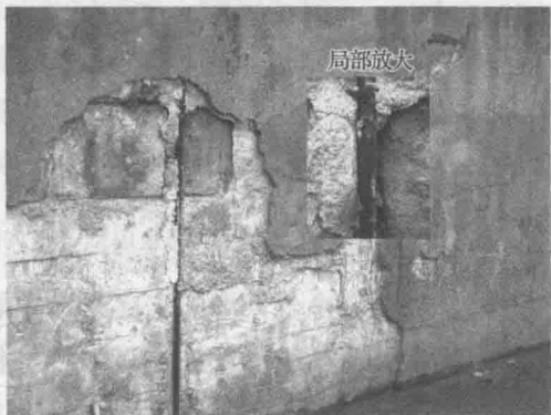
图 1.4 上海黄浦江防汛墙某段钢筋 锈蚀及混凝土裂损
