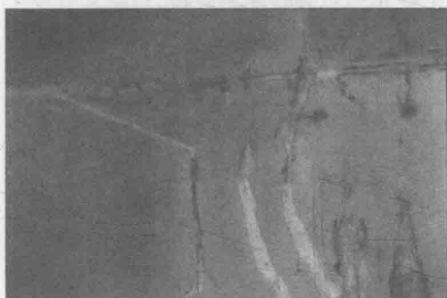
图 1.1 贵州某隧道中的渗水及修补的裂缝
