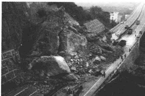
图 1-2 某高速公路边坡滑塌
