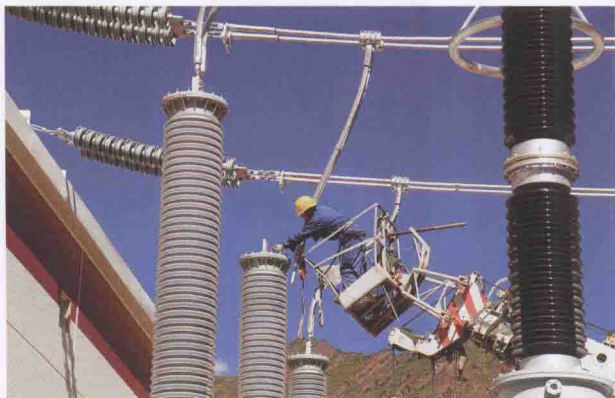
川藏电力联网工程—— 迄今为止世界上最艰难的输 变电工程
