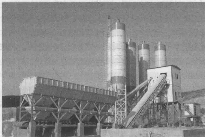
图 1-2 商品混凝土搅拌站
