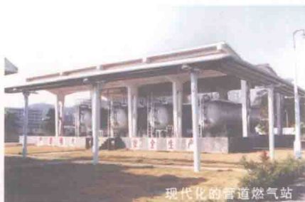
现代化的管道燃气站
