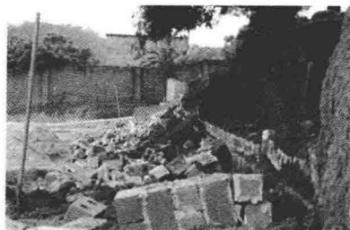
挡土墙坍塌图
