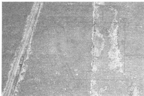
图 1-4 搭板与桥头连接处严重破碎
