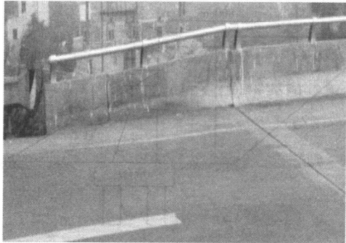
图 1-21 桥头路面和护栏明显下沉
