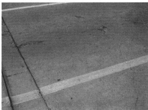
图 1-23 桥头水泥混凝土铺装层断裂
