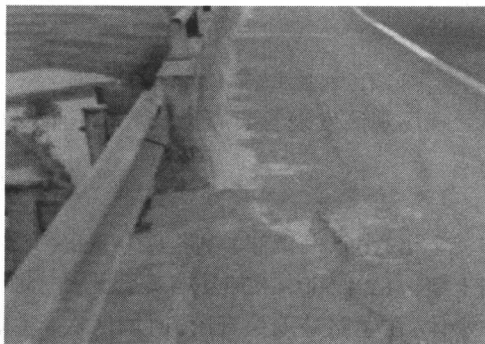
图 1-16 桥台翼墙边缘路面开裂
