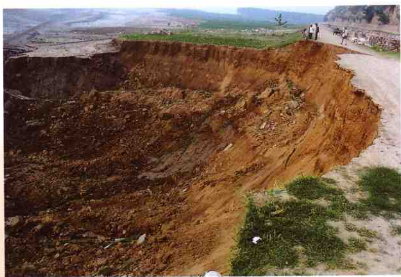
三门峡水库蓄水后山西库区出现的局部塌岸
