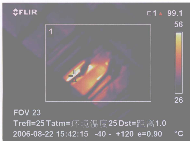
彩图 15 官亭变电站主变压器冷却器控制箱中间继电器热像图
