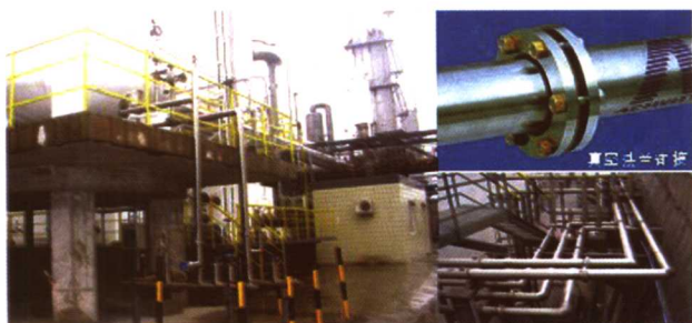
高真空多层绝热低温液体输送管道
