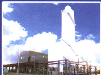
◆ 安装在内蒙通辽的 10000m 3 /h 空分设备
