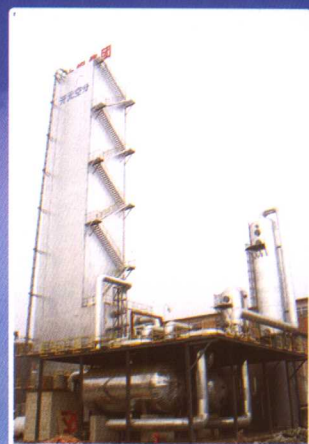
◆ 安装在四川达钢的 15000m 3 /h 空分设备
