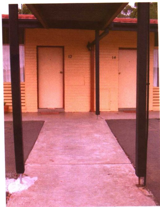
★ 一汽车旅馆走廊的木支架，离开地面约15公分，以免木材因水浸而腐烂掉。
