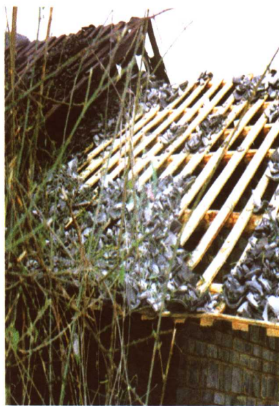
1994年4月8日，湄潭县遭雹灾。图为被雹打烂的屋顶（图片由贵州省气象档案馆提供）
