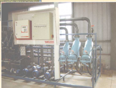
温室无土栽培营养液 灌溉首部控制枢纽
