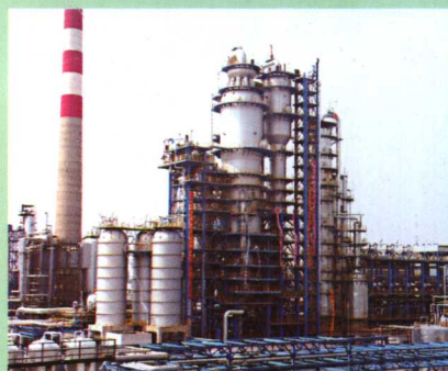
150 万吨年重油催化裂化装置。
