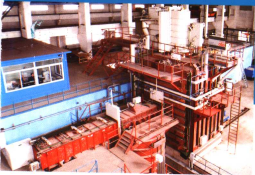
12吨真空感应炉
