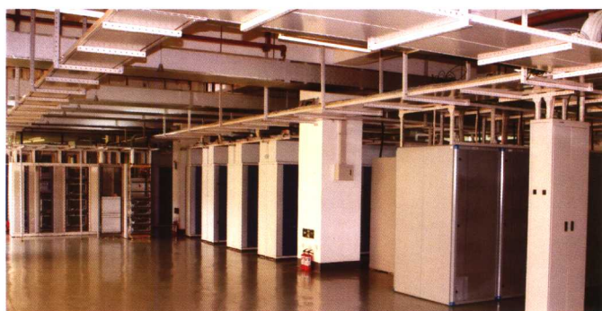
抚顺移动标准化通信机房
