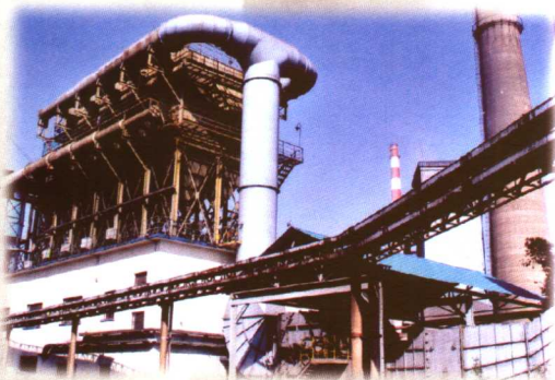
昆钢焦炉除尘系统
