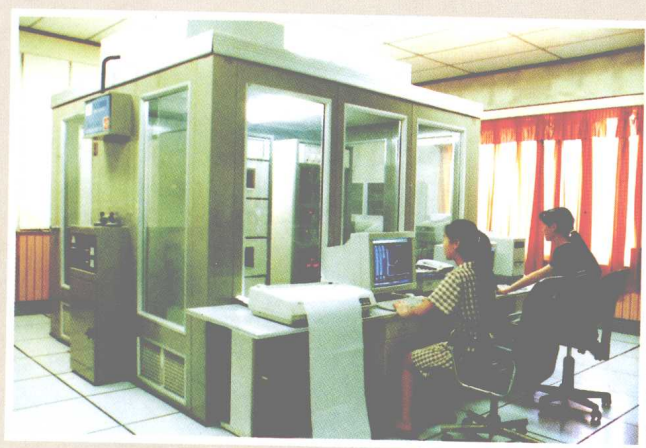
咸阳供电局电网通信中心
