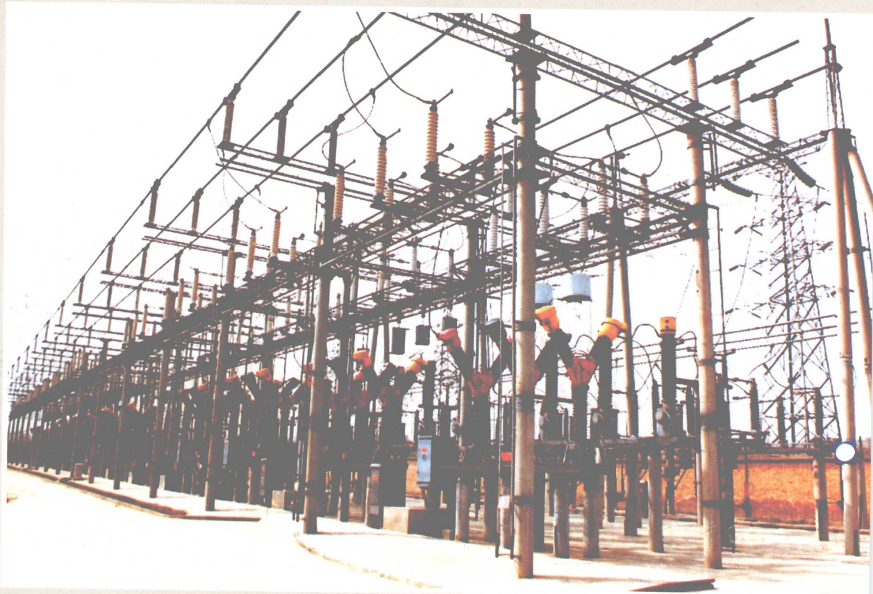
110千伏秦都变电站户外设备
