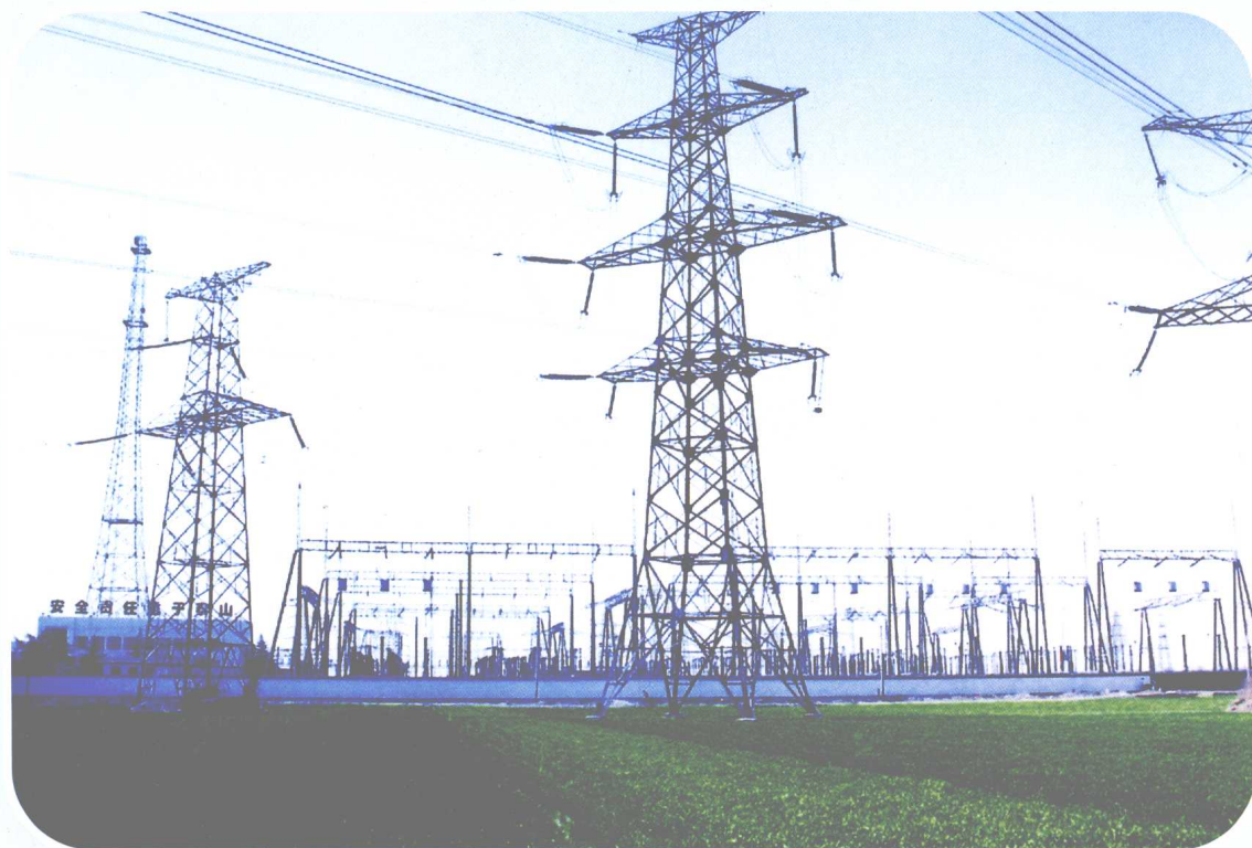
330千伏沔河变电站外景
