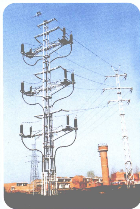
110千伏输电线路
