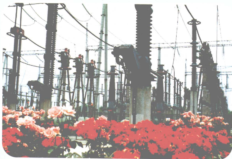
运行中的330千伏 空气开关
