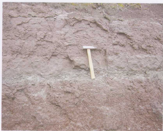
图版3-5 石柱坪隧洞铁道旁软弱夹层
