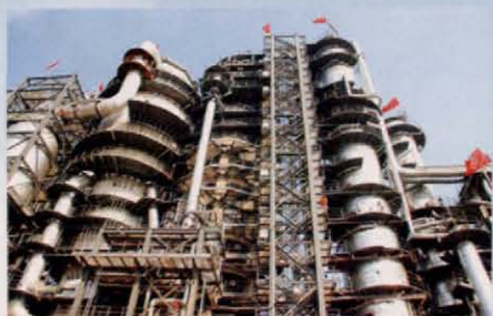
140万吨 / 年重油催化裂化装置
