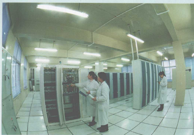
技术先进的 GSM 机房
