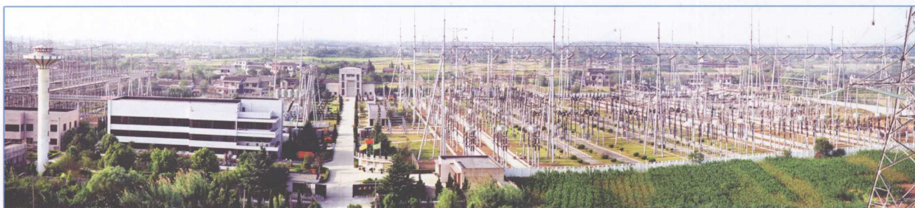
500kV江都变电所全景
