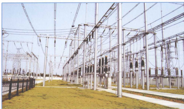
新投运的我市220kV蜀岗变电所一角
