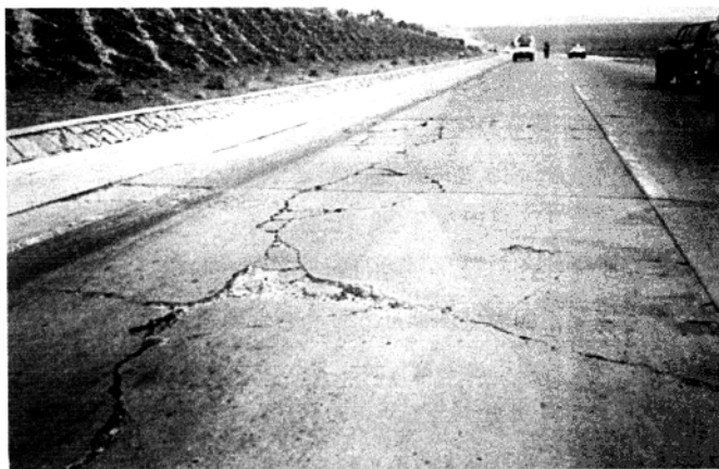
图 0-2 水泥混凝土路面纵向裂缝
