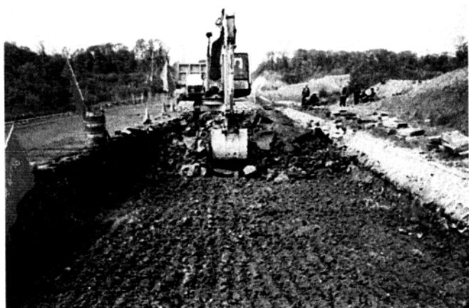
图 0-1 沥青混凝土路面翻浆处理
