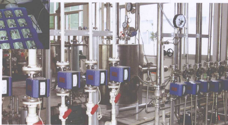
浙江广博集团股份有限公司纳米材料生产线
