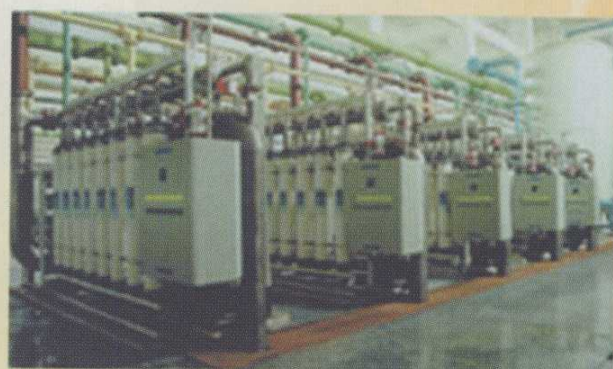
国内首台国产化600MW超临界燃煤发电机组的锅炉补给水设备。
