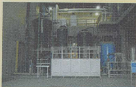
凝结水精处理设备
