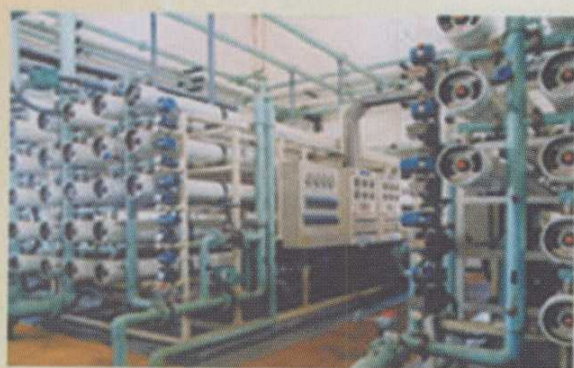
PLC程控反渗透设备(锅炉补给水)
