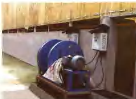
大功率轴流风机向槽底管道鼓风增氧
