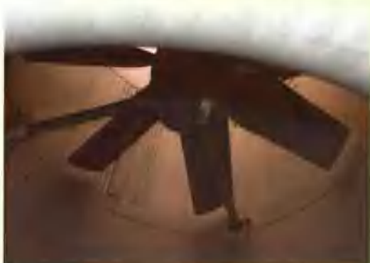
屋顶通风换气设备
