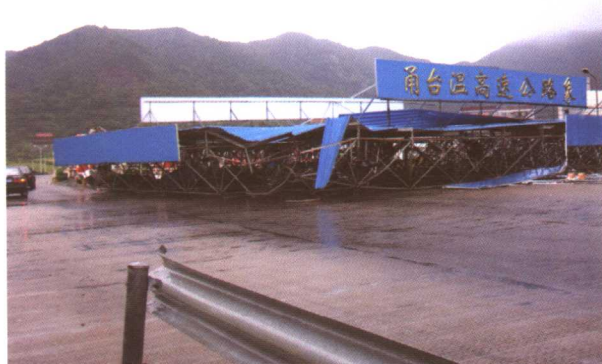
2005 年 8 月 7 日台风“麦莎”造成收费站倒塌 (浙江省象山气象局提供)
