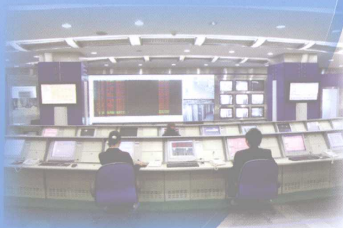
现代化集中监控中心
