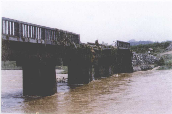
1995年7月24日，宜昌县特大暴雨，点军乡红旗桥桥身裂损，部分栏杆冲倒。栏杆上的水草表明，洪水水位高时，水是漫桥顶流过的
