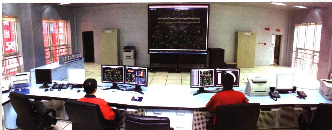
2005年11月13日，紫坪铺水利枢纽工程首批两台发电机组正式并网发电，并投入商业运行。机组每台容量19万千瓦，其所发电能通过500千伏输电线路送至华阳变电站进入成都环网。随着首批机组的投产发电，紫坪铺水利枢纽工程开始发挥灌溉、供水、发电、防洪等综合效益，成都乃至全省冬天供电紧张局面有望得到缓解。
