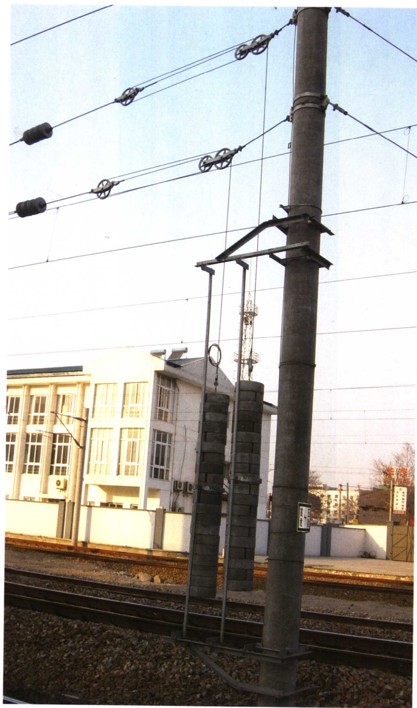
图2 沪宁电气化铁路接触网张紧装置(单建摄)
