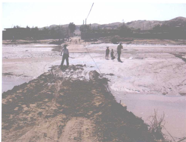
中宁县余丁乡被冲毁的路基
