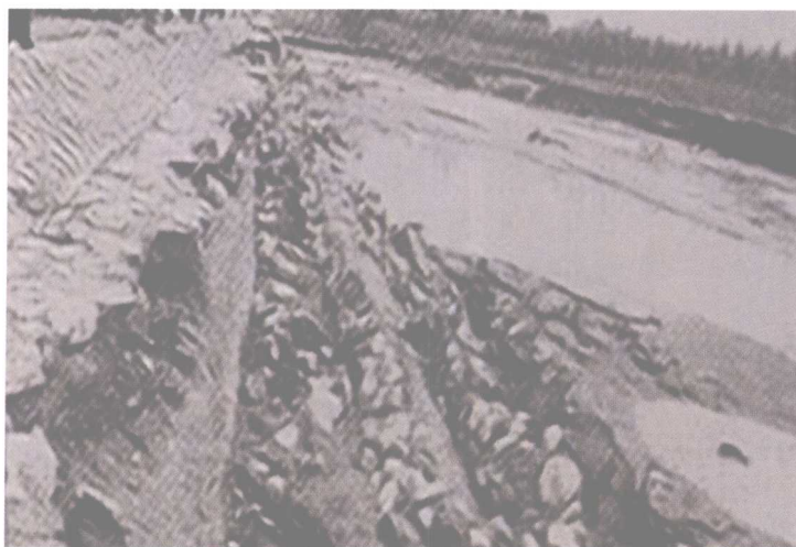
被冲毁的路基
