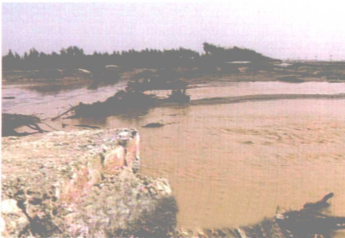
1998年5月20日，贺兰县金山乡发生特大暴雨洪水，图为西干渠决口处
