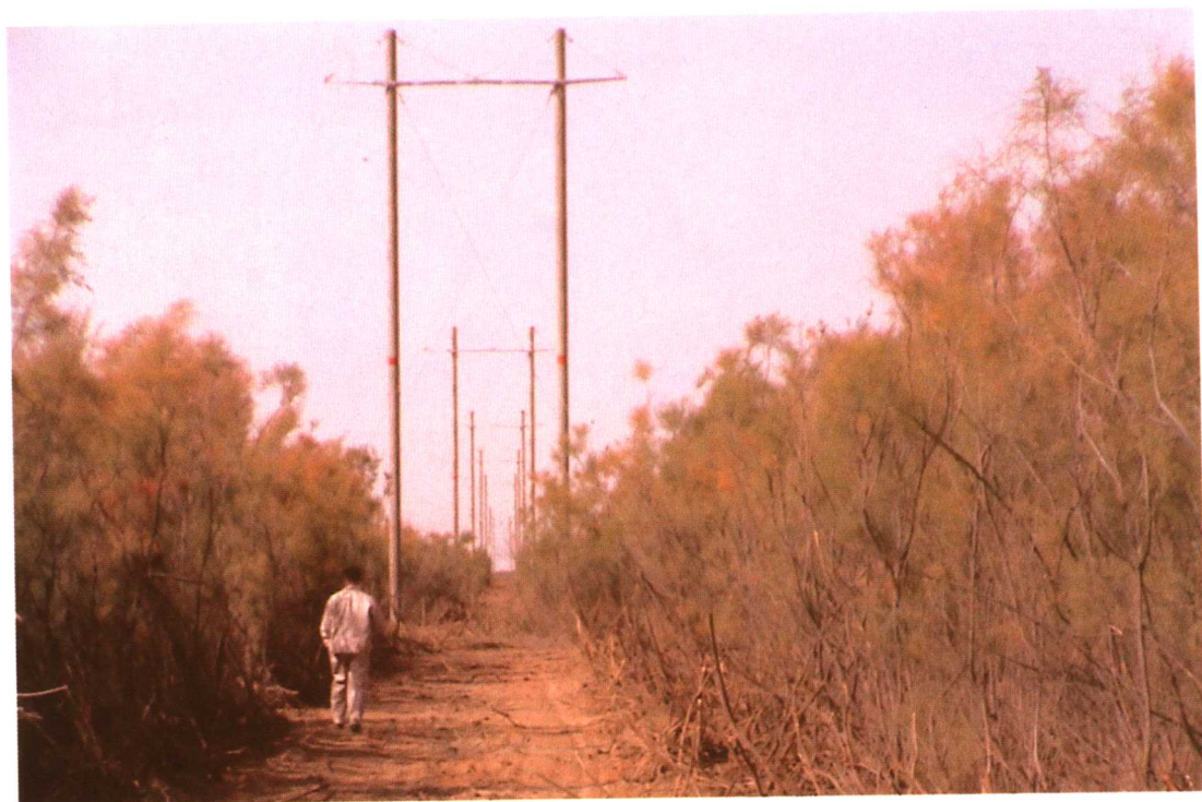
彩图 14 轮西 35kV 电力线路穿越红柳区
