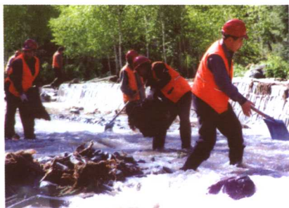
2005年6月初，国道232线喀纳斯旅游公路爆发特大水毁，阿勒泰公路总段养路职工奋力抢险
