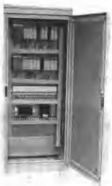
图 1.1 选用 A-B 公司 PLC 产品的某造纸设备控制柜
