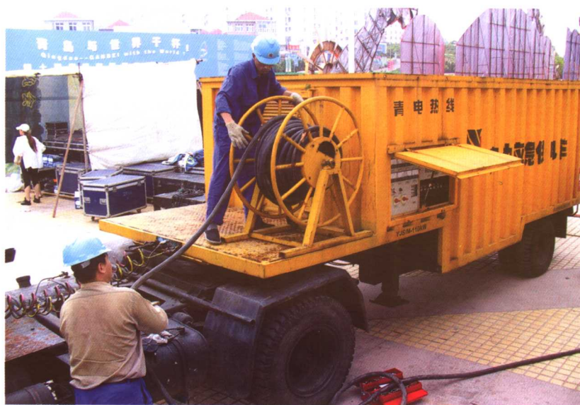
青島供电公司移动供电车为客户提供紧急供电 以及为青島市重大活動保電
