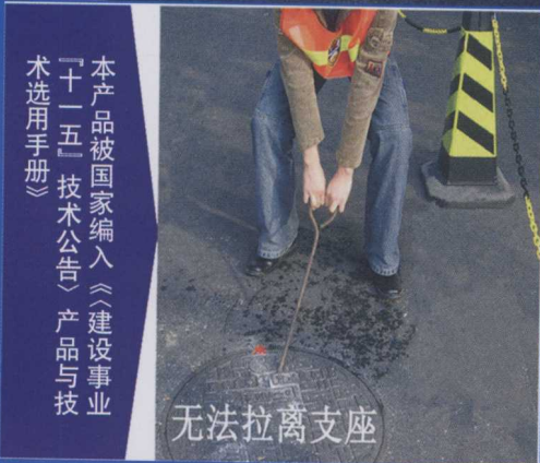
本公司专利检查井盖埋妥在北京市车公庄主路 与现在路面齐平现况
