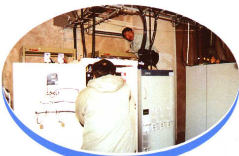
技术人员在维护基站设备
