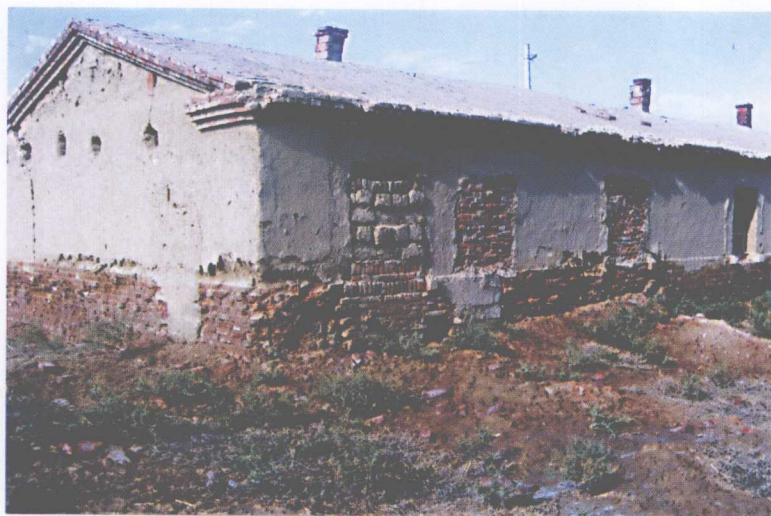
13 盐渍化地区的建设——被盐蚀的砖墙 (133团农场, 2006. 7)
